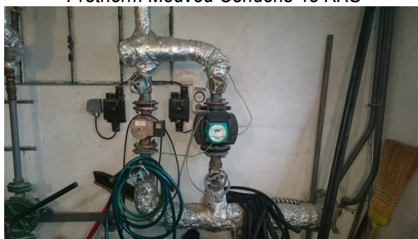
Hlavní rozvod ÚT
